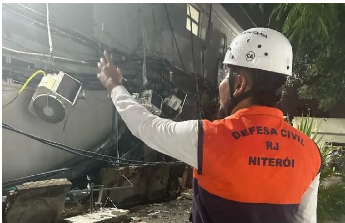
Imagem 16: Isolamento de área com risco de queda de elementos da fachada (2024).
